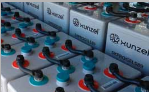
SOLARPRO-GEL™ Series –Banco de baterías
